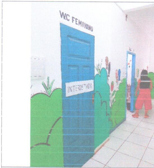
Foto: 01 – Banheiro interditado.
